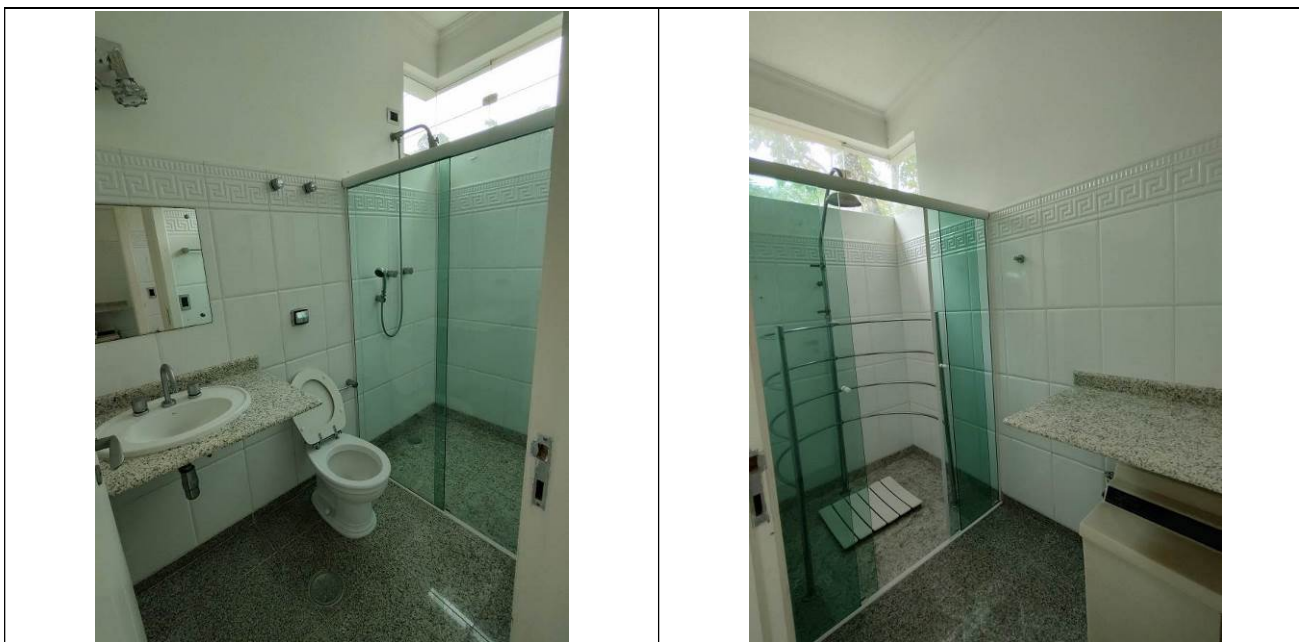
Fotos 41 e 42: Banheiro da sauna
