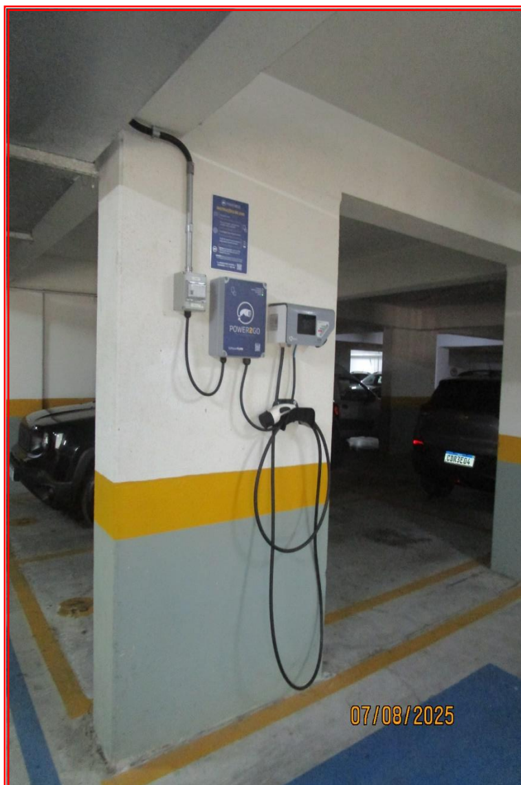
Foto nº 37: Detalhe para o sistema de carregador para veículo elétrico.
