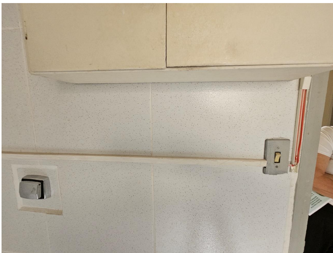
50 – Unidade autônoma – Apartamento nº 62 – Registro de anomalias
