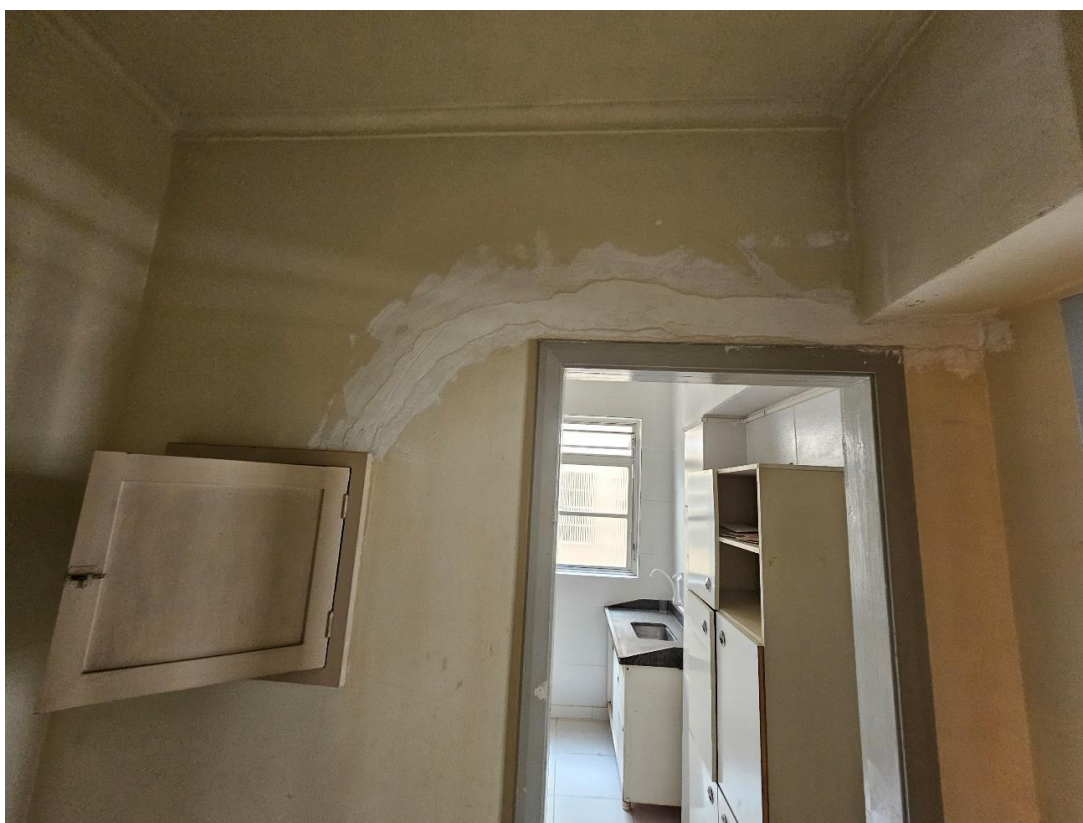
52 – Unidade autônoma – Apartamento nº 62 – Registro de anomalias
